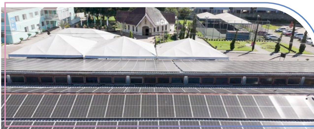
Painéis solares, instalados em 2023.
