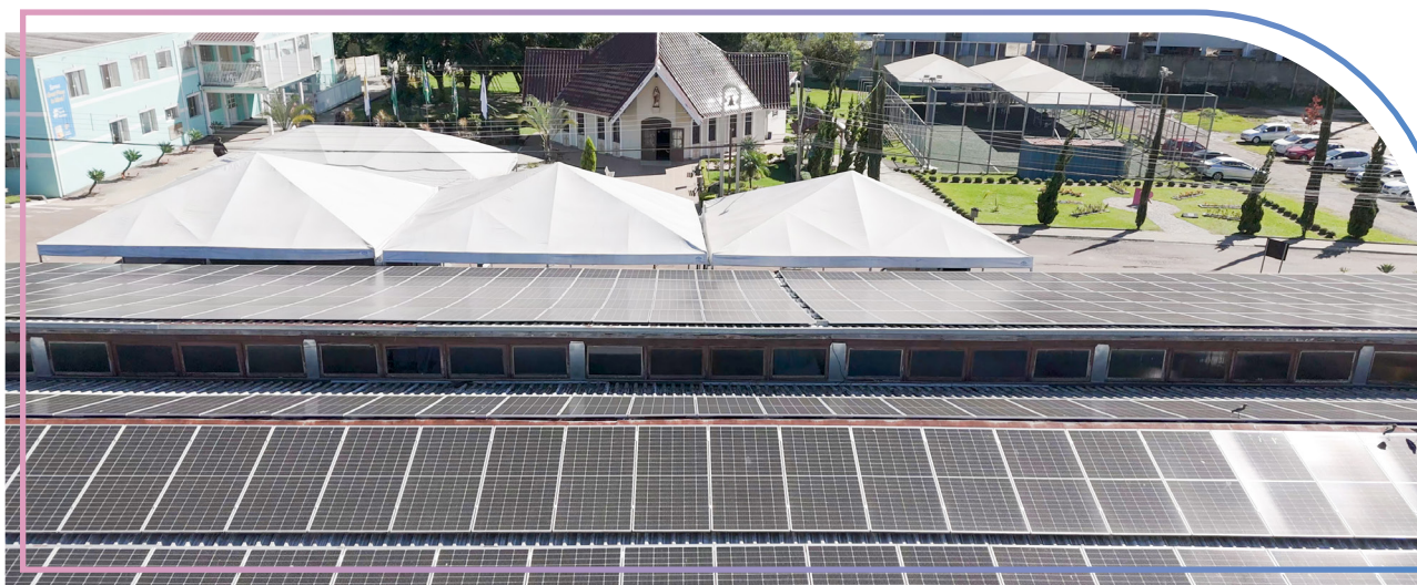
Painéis solares, instalados em 2023.
